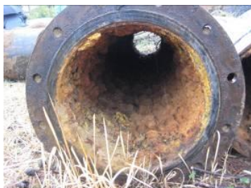
図 1 内面が腐食した水道管
