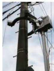
劣化部近距離撮影 (360°撮影)型
