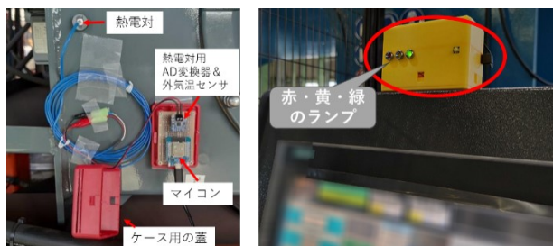
図1 油タンクに設置したセンサと温度通知用表示器
