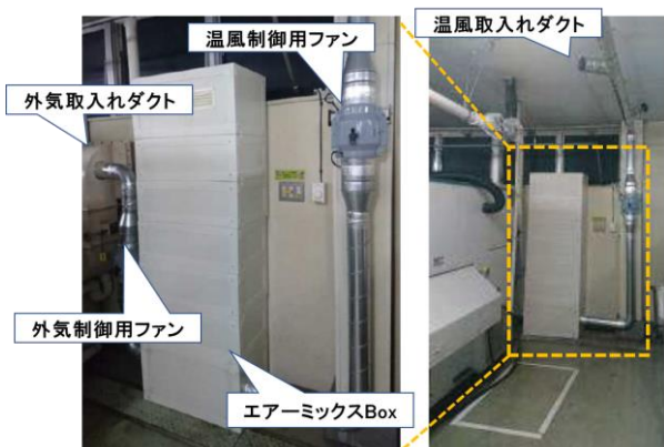
図 5 エアーミックス Box の設置写真
